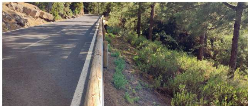
Figura 6. Aspecto del borde de la carretera en la localidad nº 11 (Rosa de Piedra), tras el trabajo de corta realizado meses antes por el servicio de Conservación de Carreteras, con acumulación de pinocha en el suelo.
